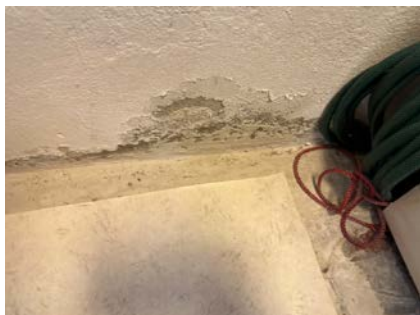
Spor etter fukt i mur.
