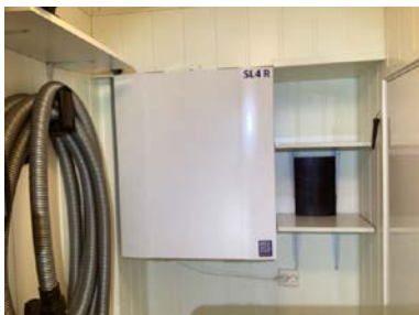
Ventilasjonsenhet lokalisert på bod.
