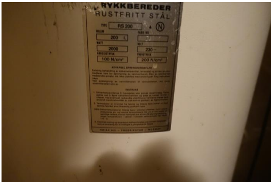
Bildet viser varmtvannsbereider, 200 liter
