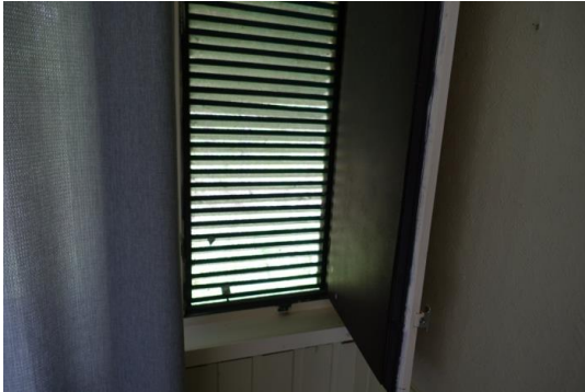
Bildet viser luftevindu, uten vindu men med myggnetting, fra byggeår.
