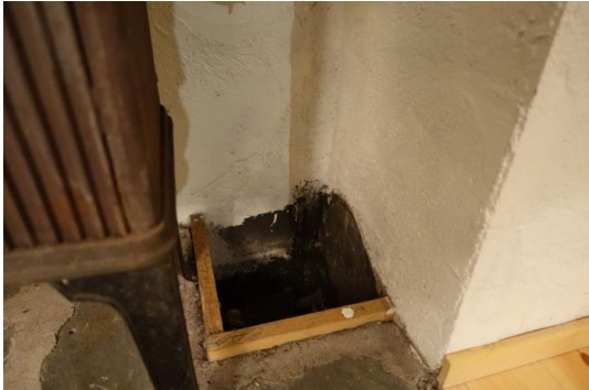
Bildet viser feieluke i kjelleretasje. Feieluke er ikke godkjent.
