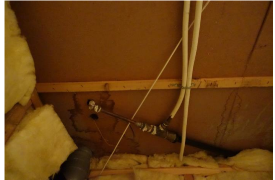
Bildet viser røropplegg
