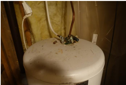
Bilde viser varmtvannsbereider
