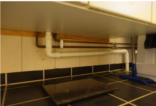
Bildet viser utenpåliggende rør på baderom
