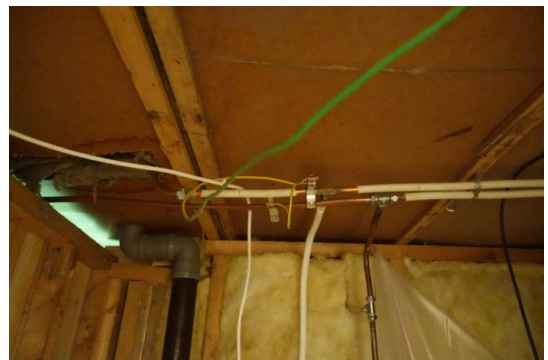
Bildet viser røropplegg
