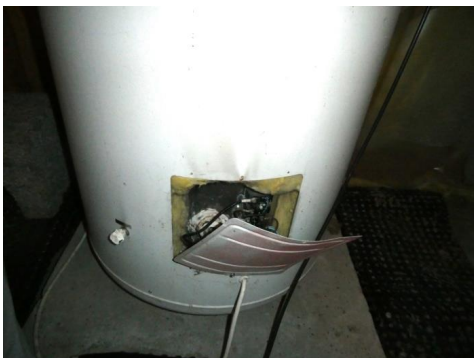
Ikke godkjent tilkobling varmtvannsbereder
