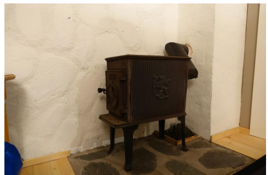
Bildet viser vedovn i kjellerrom
