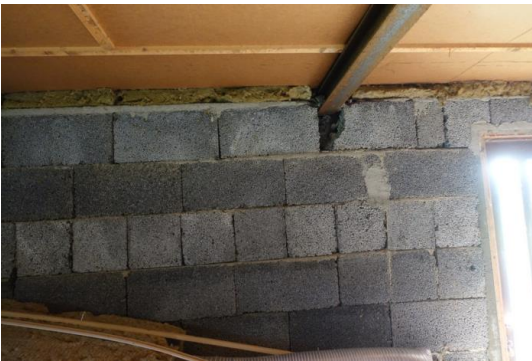
Bildet viser stort trykk på opplagret jerndrager i kjelleretasjen.
