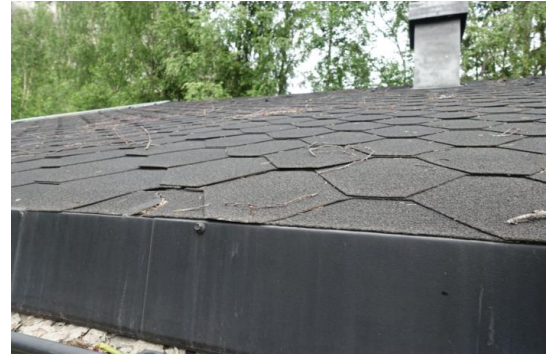
Pappshingel fra byggeår - 40 ihht byggeår - retekking må påregnes.
