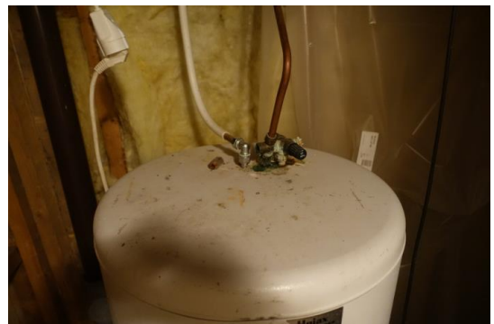
Bildet viser røropplegg
