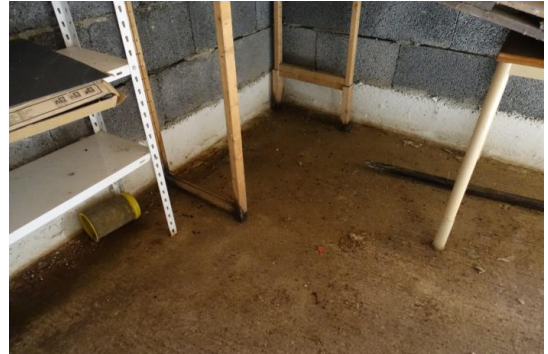
Bilodet viser synlig fukt.
