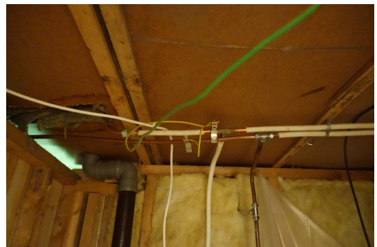
Bildet viser røropplegg
