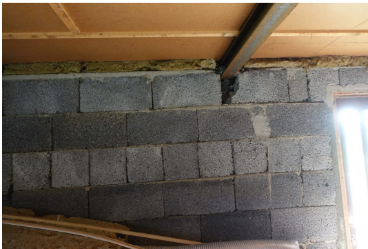
Bildet viser stort trykk på opplagret jerdrager i kjelleretasjen.
