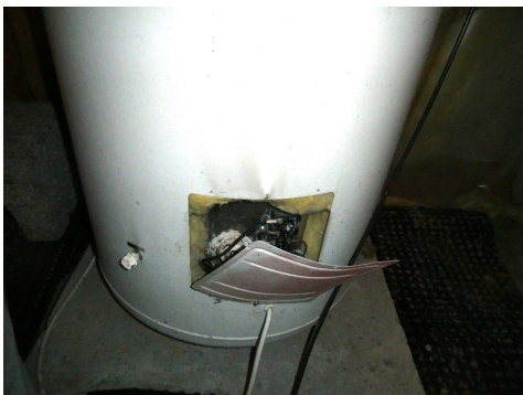
Ikke godkjent tilkobling varmtvannsbereder
