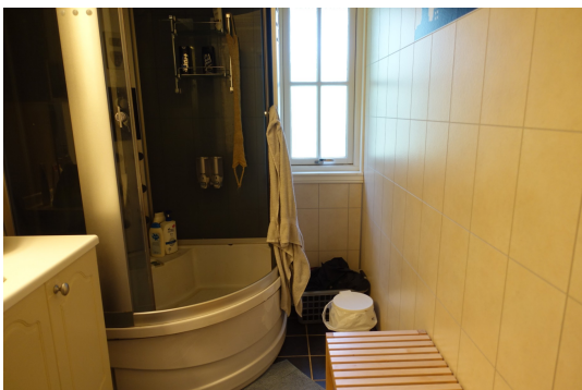
Bildet viser dusjkabinett etablert inn i vindu, glippe på baderomsplater i hjørne.
