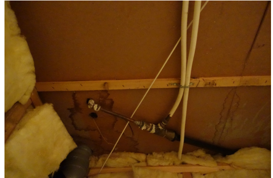
Bildet viser røropplegg
