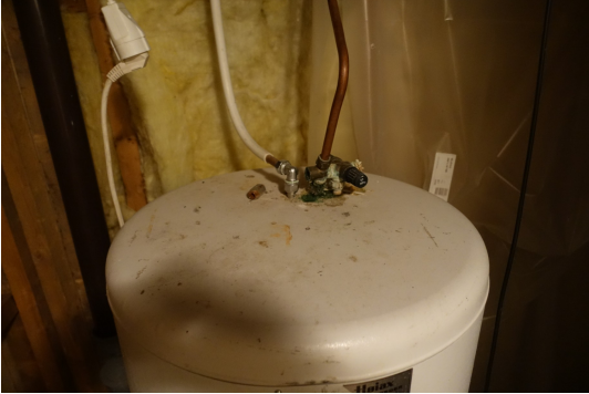
Bilde viser varmtvannsbereder
