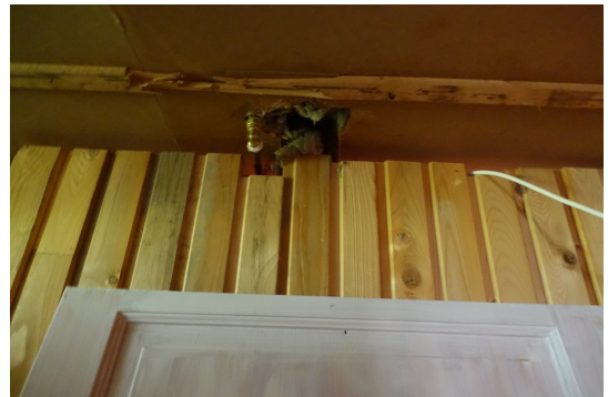
Bildet viser hull tatt under kjøkken, viser spor av fuktskader.
