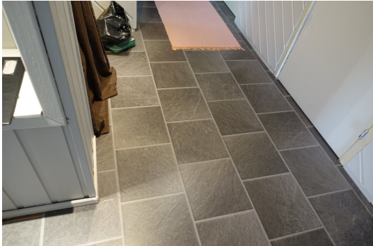
Bildet viser belegg på gulv i gang hovedetasje.
