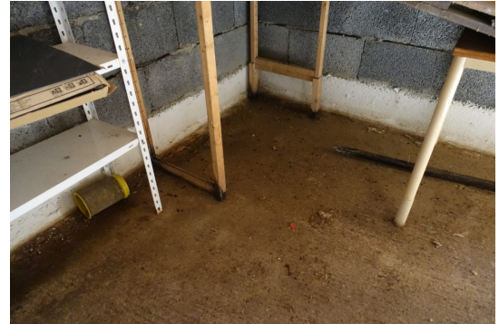
Bildet viser synlig fukt.
