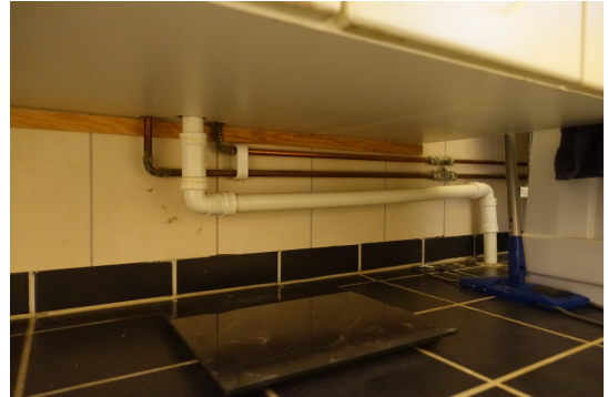
Bildet viser utenpåliggende vannrør. Bildet viser glipper mellom flisgulvoppbrett og baderomsplater
