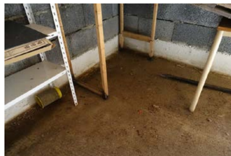
Bilodet viser synlig fukt.
