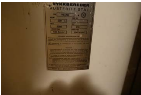
Bildet viser varmtvannsbereider, 200 liter
