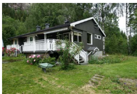
Bildet viser deler av rekkverk på veranda, reparert og skiftet råteskader i rekkverk
