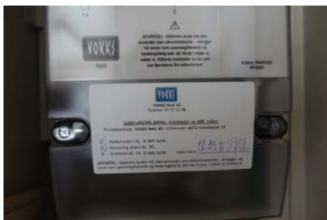
Bildet viser installert AMS-måler
