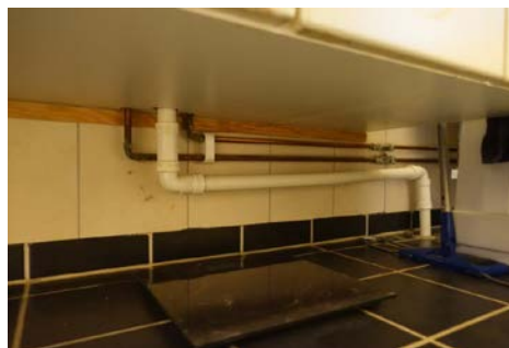
Bildet viser utenpåliggende vannrør. Bildet viser glipper mellom flisgulvoppbrett og baderomsplater
