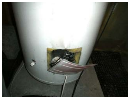
Ikke godkjent tilkobling varmtvannsbereder
