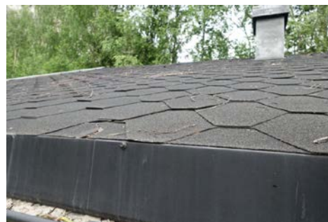
Pappshingel fra byggeår - 40 ihht byggeår - retekking må påregnes.
