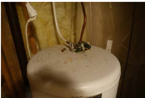
Bilde viser varmtvannsbereider
