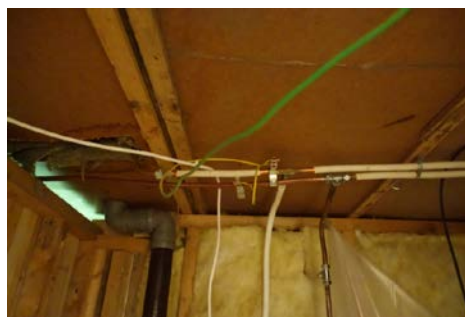
Bildet viser røropplegg
