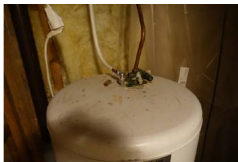
Bildet viser røropplegg
