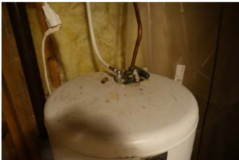
Bilde viser varmtvannsbereder
