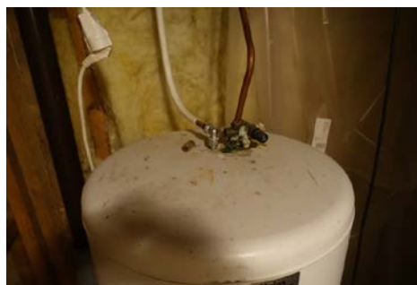
Bildet viser rørøpplagg
