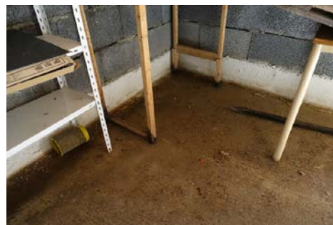
Bilodet viser synlig fukt.
