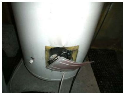
Ikke godkjent tilkobling varmtvannsbereder
