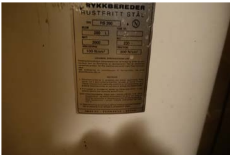
Bildet viser varmtvannsbereder, 200 liter
