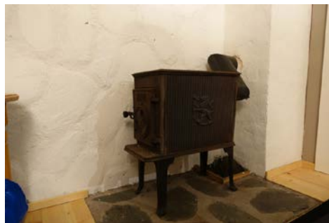
Bildet viser vedovn i kjellerrom
