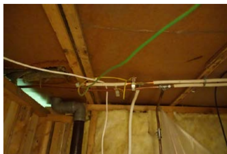
Bildet viser rørøpplagg
