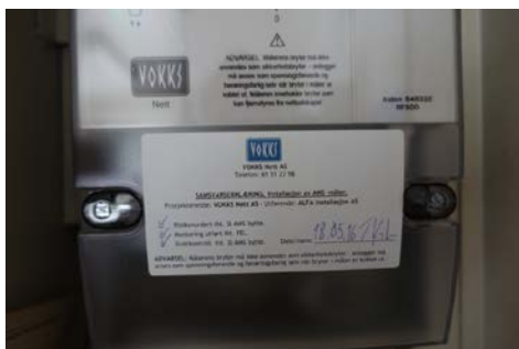
Bildet viser installert AMS-måler
