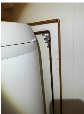
Bildet viser vannkran på boden.
