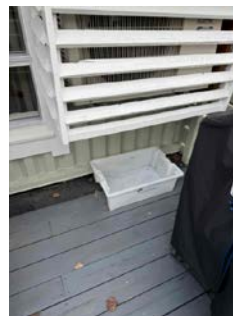
Bildet viser plastbeholder under utedel for oppsamling av vann fra varmepumpe.
