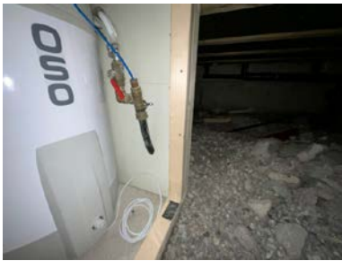
Varmekabel i vannrøret.
