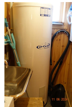
Varmtvannstank stående i teknisk rom.
