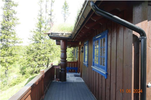
Nedløp av nedløpsrør.
