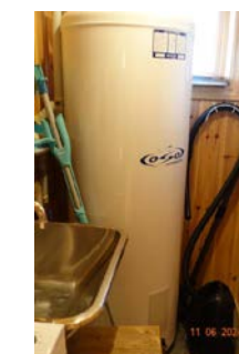
Varmtvannstank stående i teknisk rom.
