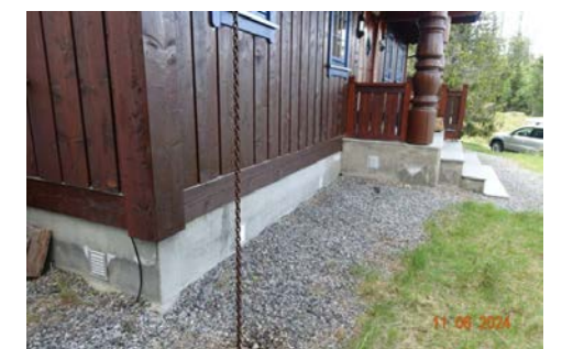
Nedløp av kjetting.
