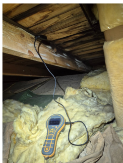
Fuktskjolder/skader i undertak.
