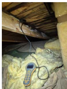
Fuktskjolder/skader i undertak.
