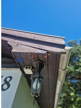
Råteskader i vindskeer og gesims.
