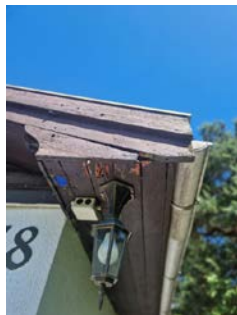
Råteskader i vindskier og gesims.
