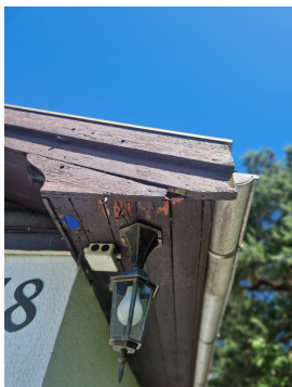
Råteskader i vindskier og gesims.
