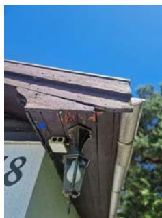
Råteskader i vindskier og gesims.
