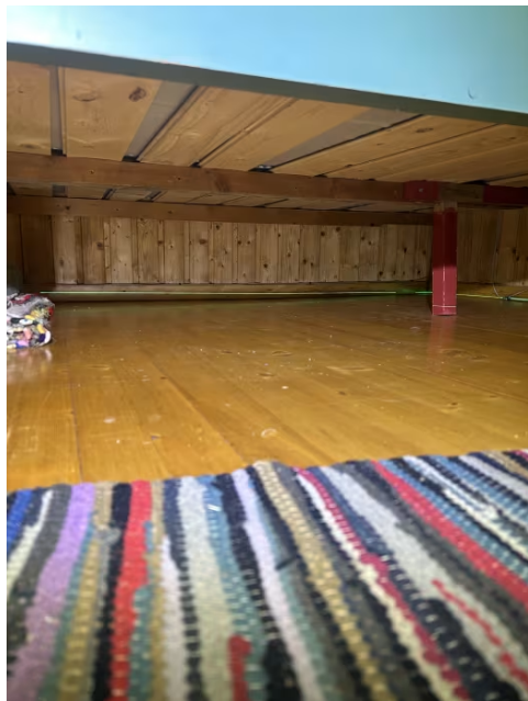
Skjevhet på bjelkelag.
