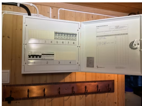
Sikringskap plassert i gang.
