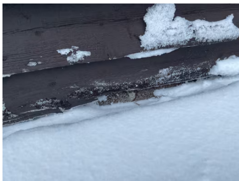
Skade på panelbord ved terrasse.
