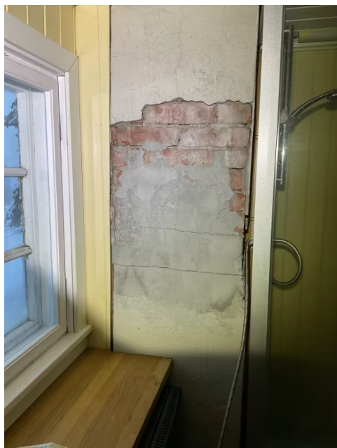
Avskallinger og sprekker i puss.
