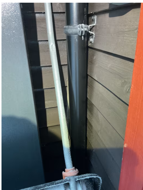
Frostspreng på nedløp ved inngangsdør.
