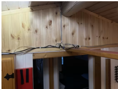
Løse kabler for solcelleanlegg.
