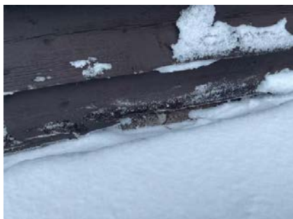
Skade på panelbord ved terrasse.
