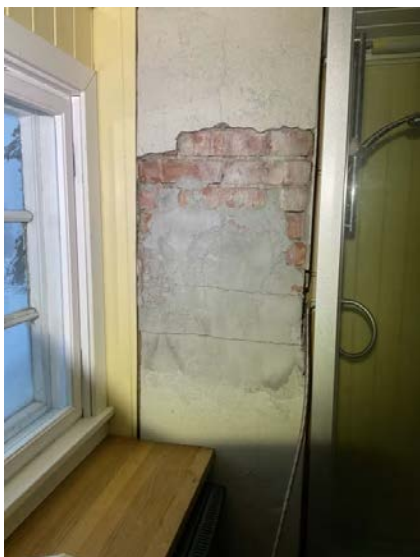
Avskallinger og sprekker i puss.
