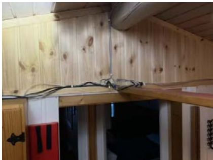
Løse kabler for solcelleanlegg.
