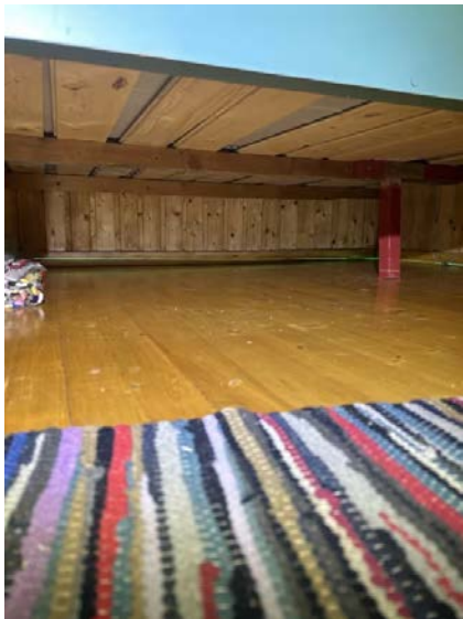
Skjevhet på bjelkelag.
