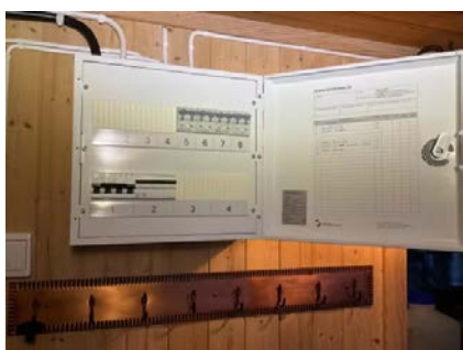
Sikringskap plassert i gang.
