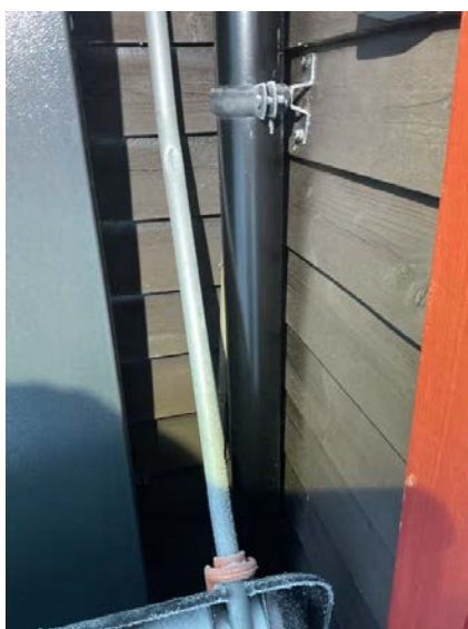
Frostspreg på nedløp ved inngangsdør.
