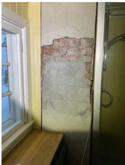
Avskallinger og sprekker i puss.
