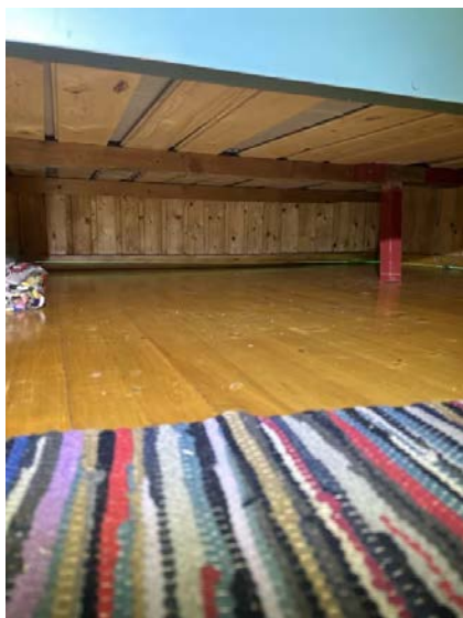
Skjevhet på bjelkelag.
