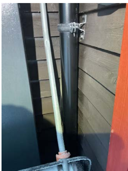
Frostspreg på nedløp ved inngangsdør.
