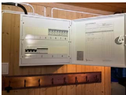
Sikringskap plassert i gang.
