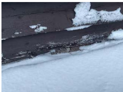
Skade på panelbord ved terrasse.
