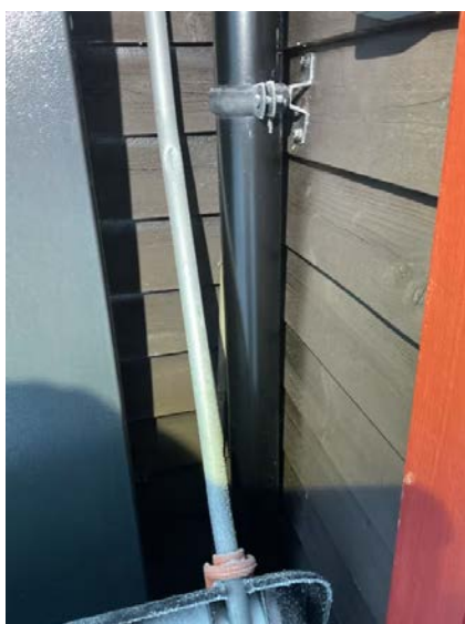
Frostspreg på nedløp ved inngangsdør.
