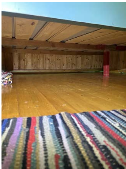
Skjevhet på bjelkelag.
