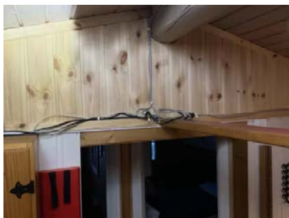
Løse kabler for solcelleanlegg.
