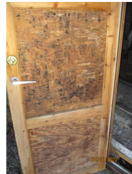
Fuktskader/svartsopp i kjellerdør
