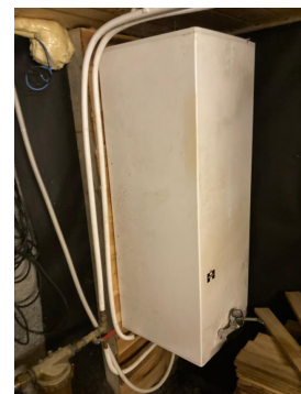
Eldre varmtvannsvereder som er montert i kjeller.
