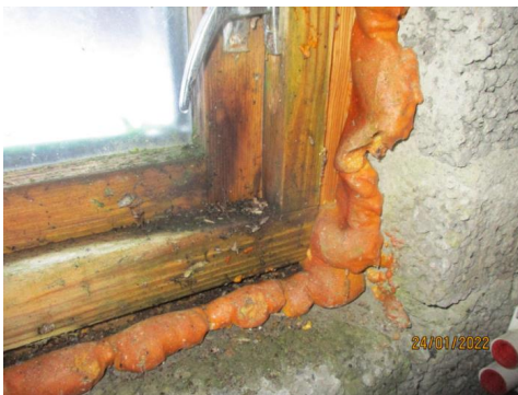
Fukt/råte i vindu i kjeller
