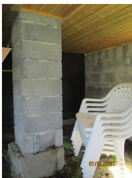
Pipe i kjeller med sotluke, ikkje pussa
