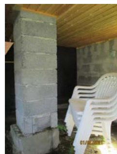
Pipe i kjeller med sotluke, ikkje pussa
