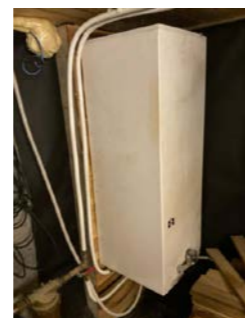
Eldre varmtvannsbereder som er montert i kjeller.
