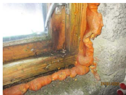
Fukt/råte i vindu i kjeller
