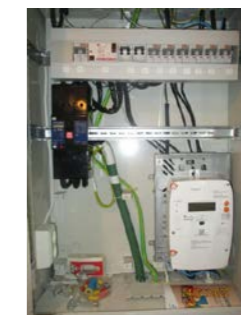
El-skap med automatsikringer
