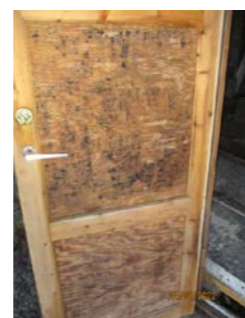
Fuktskader/svartsopp i kjellerdør
