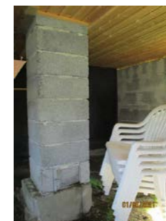
Pipe i kjeller med sotluke, ikkje pussa
