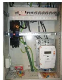
El-skap med automatsikringer
