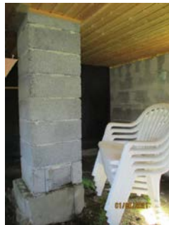
Pipe i kjeller med sotluke, ikkje pussa
