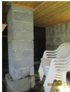
Pipe i kjeller med sotluke, ikkje pussa
