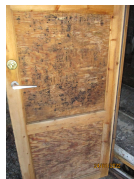
Fuktskader/svartsopp i kjellerdør
