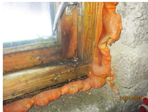
Fukt/råte i vindu i kjeller
