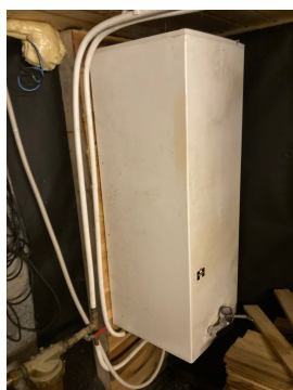
Eldre varmtvannsvereder som er montert i kjeller.
