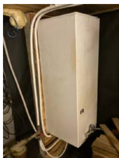
Eldre varmtvannsvereder som er montert i kjeller.
