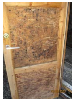
Fuktskader/svartsopp i kjellerdør
