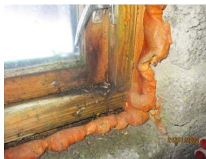
Fukt/råte i vindu i kjeller
