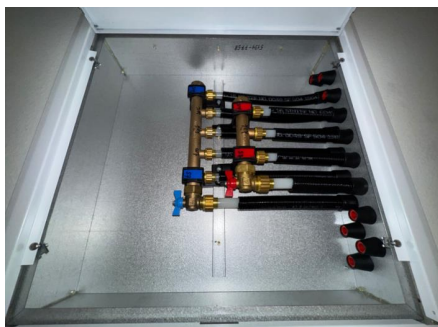
Vannfordelerskap på bad/wc
