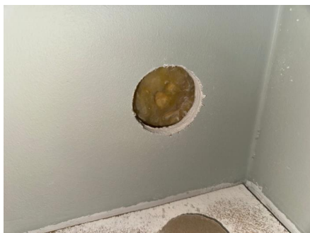
Hulltaking i tilstøtende soverom
