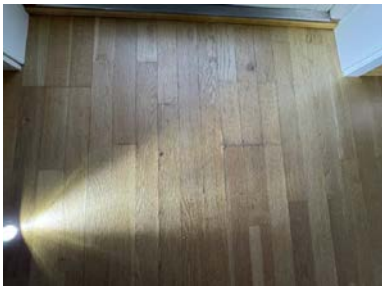
Parkettgulv foran balkongdør har svelleskade i skjøter.
