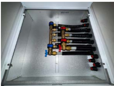
Vannfordelerskap på bad/wc
