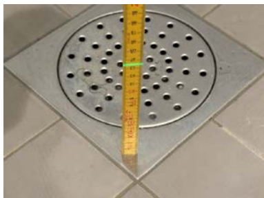
Fallforhold ca. 135 mm topp slukrist i dusjsone
