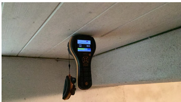
Fuktnnhold på ca. 18 vektprosent i treverk i kjeller.
