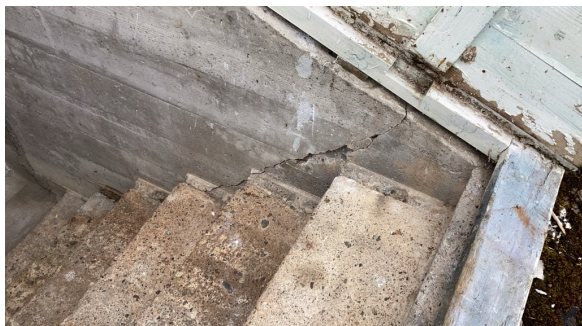
Sprekk i vegg i kjellertrapp.
