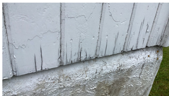
Eksempel på sprekker i kledningsbord.
