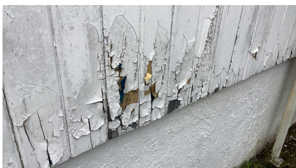
Eksempel på slitasje.
