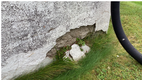
Avskaling på mur.
