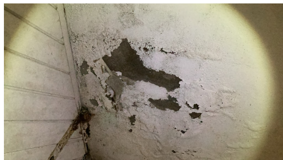
Eksempel på avskaling på vegg.
