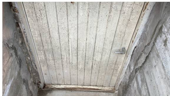
Svertesopp på overflater på kjellerdør.
