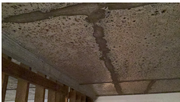
Eksempel på svertesopp i himling.
