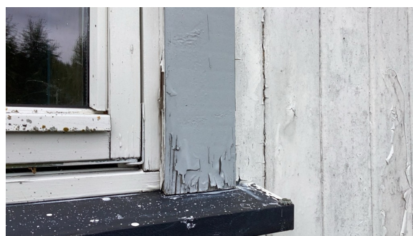
Eksempel på slitasje.
