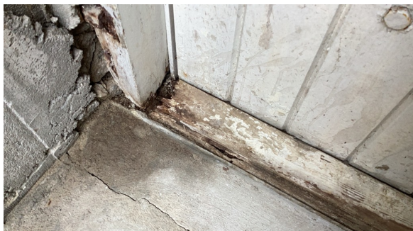
Råte i terskel på dør til kjeller.
