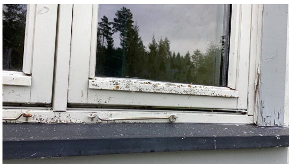
Eksempel på slitasje på vindu med isolerglass.
