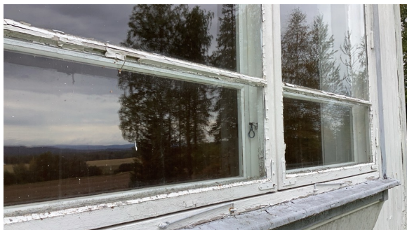
Eksempel på slitasje på vindu med enkelt glass og vareramme.
