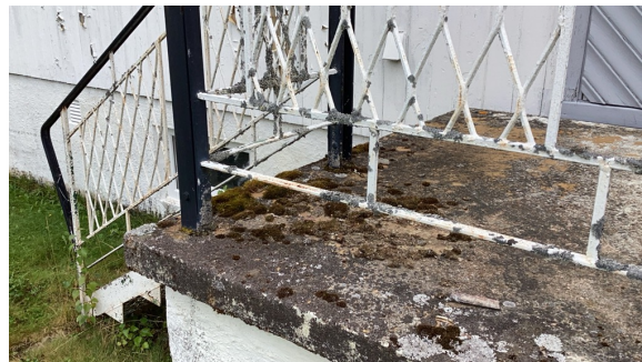
Eksempel på slitasje og mosevekst.
