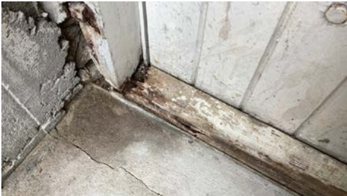
Råte i terskel på dør til kjeller.
