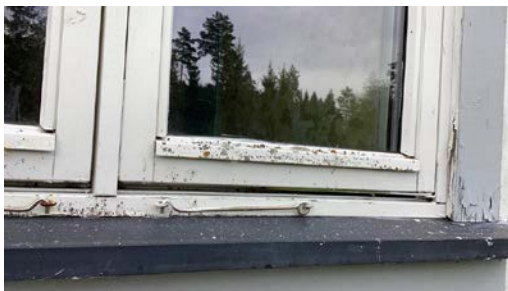
Eksempel på slitasje på vindu med isolerglass.
