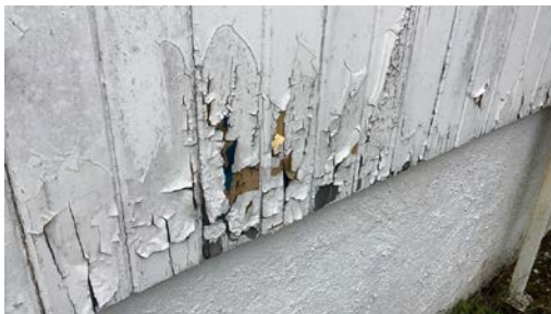
Eksempel på slitasje.
