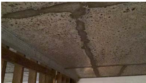
Eksempel på svertesopp i himling.
