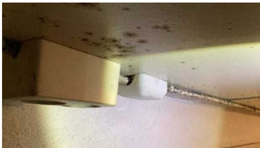
Eksempel på forhold som vil medføre avvik ved en el-kontroll.
