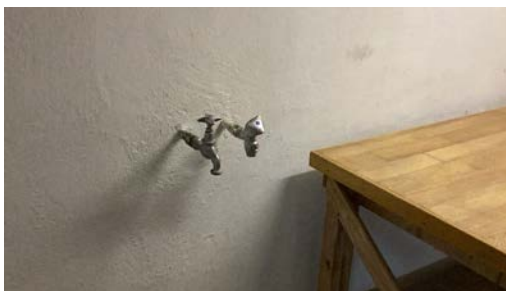
Vannkraner i kjeller.
