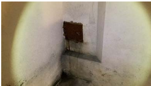
Sotluke i kjeller.
