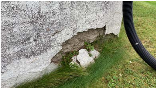
Avskaling på mur.
