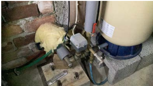
Vanninntak og stoppekran i kjeller.
