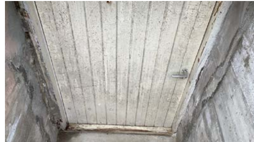
Svertesopp på overflater på kjellerdør.
