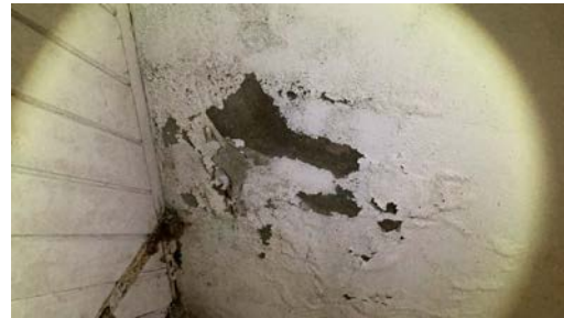
Eksempel på avskaling på vegg.
