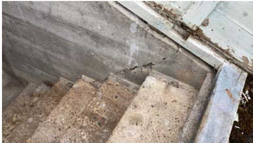
Sprekke i vegg i kjellertrapp.
