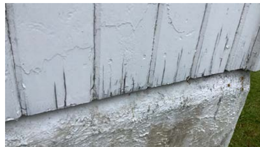
Eksempel på sprekker i kledningsbord.
