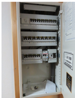
Skap med sikringsautomater i u.etg.
