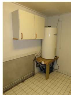
Del av vaskerom. Vanninntak og varmtvannsbereder.
