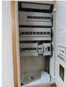
Skap med sikringsautomater i u.etg.
