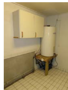
Del av vaskerom. Vanninntak og varmtvannsbereder.
