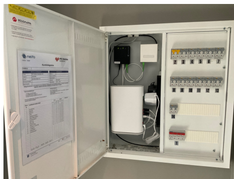
Sikringsskap i entreen
