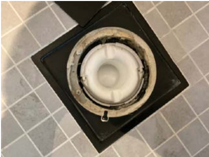
Sluk i dusjnise 2. etasje
