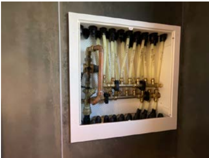
Rør-i-rør skap på baderom
