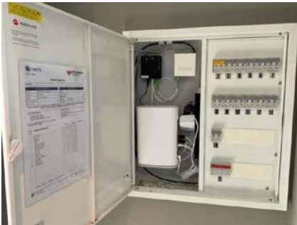
Sikringsskap i entreen
