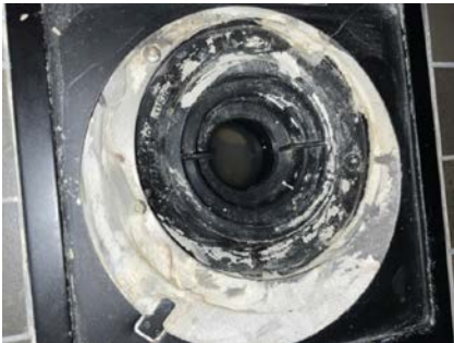
Sluk i dusjnise 1. etasje
