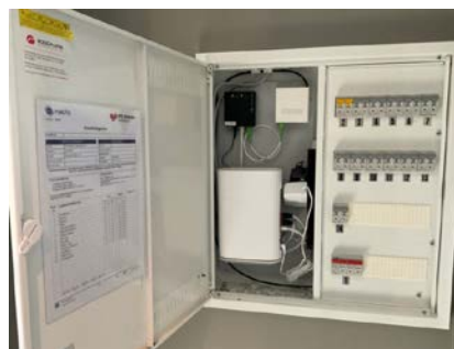
Sikringskap i entreen
