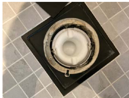
Sluk i dusjnise 2. etasje
