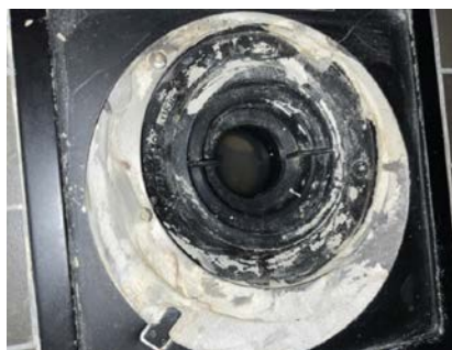
Sluk i dusjnise 1. etasje
