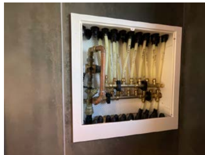
Rør-i-rør skap på baderom
