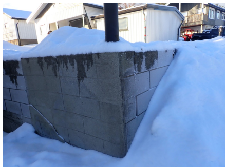
Sprekker i støttemur.
