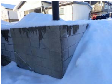
Sprekker i støttemur.
