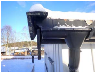
Dårlig tilstand på vindskier. Flasset beleg i takfotbeslag.
