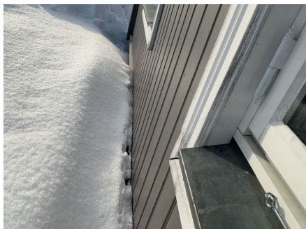
Værslitte utvendige karmlister registrert.
