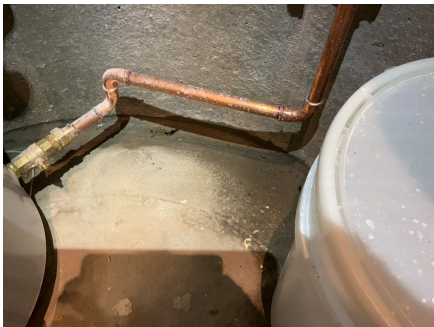
Synlig fukt på støpt gulv i teknisk brønn.
