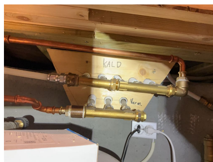
Vannfordelere i teknisk brønn.
