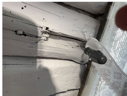
Det er registrert enkelte råteskader i opprinnelig tømmervegg. Forholdet gis tilstandsgrad 3, i henhold til NS3600.
