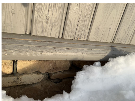
Værslitt kledning enkelte steder.
