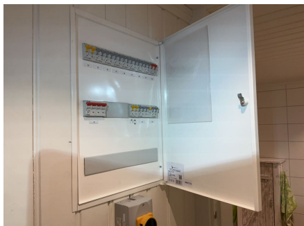
Sikringsskap utenfor bad.
