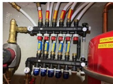
Fordelere i teknisk brønn.
