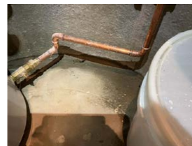
Synlig fukt på støpt gulv i teknisk brønn.
