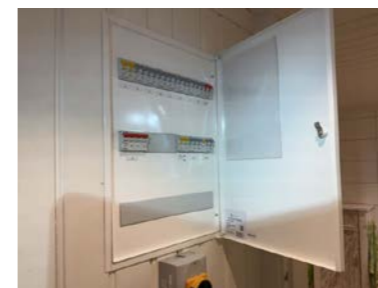
Sikringsskap utenfor bad.
