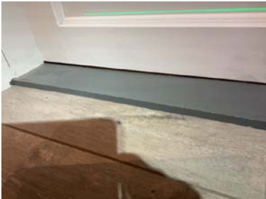
Tilluftsspalte under dør er ikke tilstrekkelig stor.
