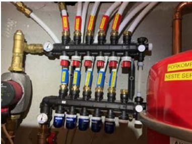
Fordelere i teknisk brønn.
