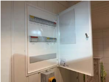
Sikringsskap utenfor bad.
