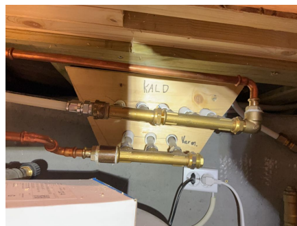
Vannfordelere i teknisk brønn.
