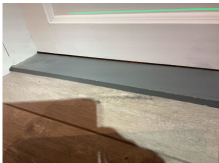
Tilluftsspalte under dør er ikke tilstrekkelig stor.
