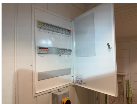
Sikringsskap utenfor bad.
