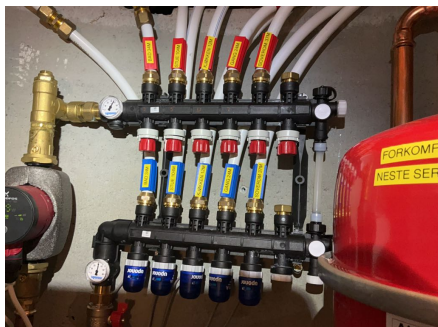
Fordelere i teknisk brønn.
