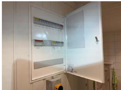
Sikringsskap utenfor bad.
