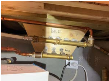
Vannfordelere i teknisk brønn.
