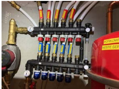
Fordelere i teknisk brønn.
