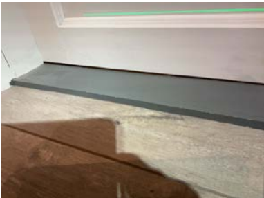
Tilluftsspalte under dør er ikke tilstrekkelig stor.
