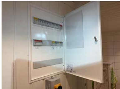
Sikringsskap utenfor bad.
