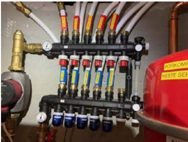
Fordelere i teknisk brønn.
