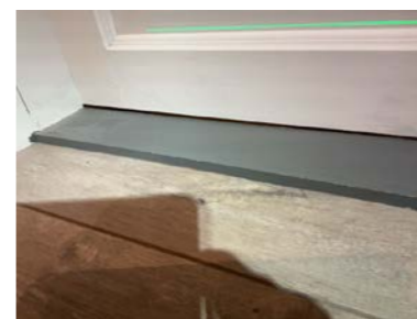
Tilluftspalte under dør er ikke tilstrekkelig stor.
