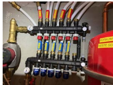
Fordelere i teknisk brønn.
