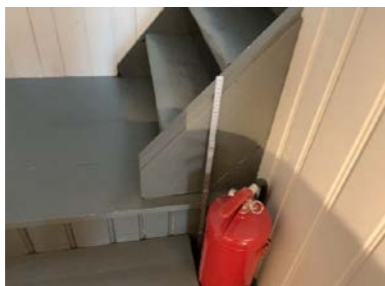
Manglende rekkverk i deler av trapp. Forholdet gis tilstandsgrad 3.
