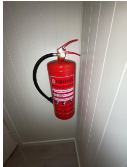
Brannslukker på soverom fra 2022
