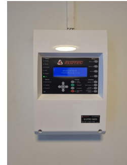
Felles brannsentral i felles gang ved hovedinngang
