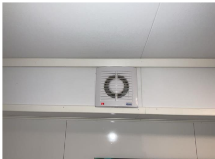
Mekanisk avtrekksvifte på vegg/kanal
