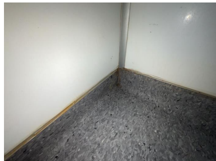
- Slitt og misfarget mykfuge i hjørne inne i dusj mellom sokkellist og våtromsplater
