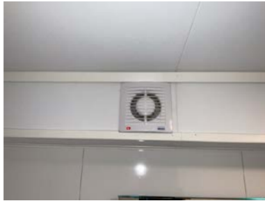
Mekanisk avtrekksvifte på vegg/kanal
