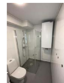
Ikke montert bunnlister på dusjdører, anbefaler å montere disse for å unngå vannsøl utenfor dusjsonen
