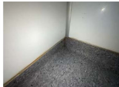
- Slutt og misfarget mykfuge i hjørne inne i dusj mellom sokkellist og våtromsplater
