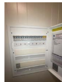
Sikringskap er plassert i vindfang
