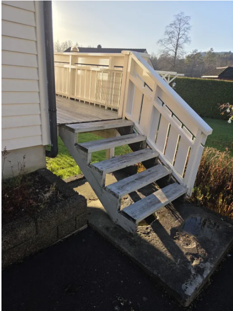
Rekkverk trapp mangler.
