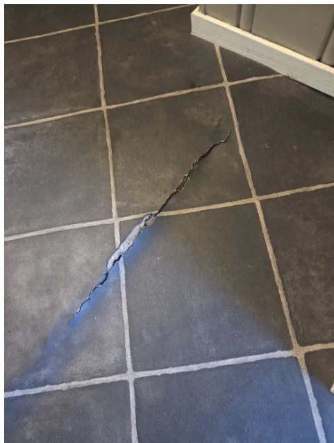
Sprekk i belegg i entré.
