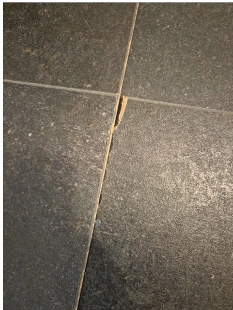
Sprekk i belegg/klikk-vinyl i gang underetasje.
