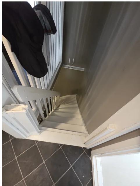
Håndløper trapp mangler.
