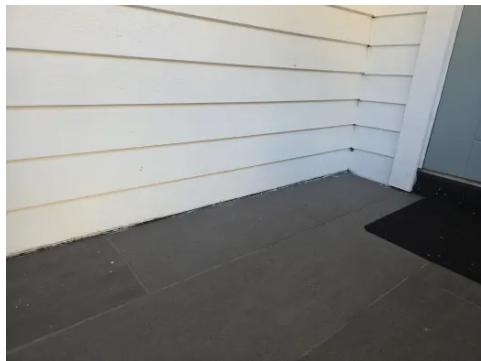
Manglende lufting av kledning ved inngangsparti.
