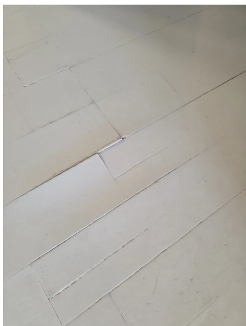
Sprekk i parkett i stue/kjøkken.
